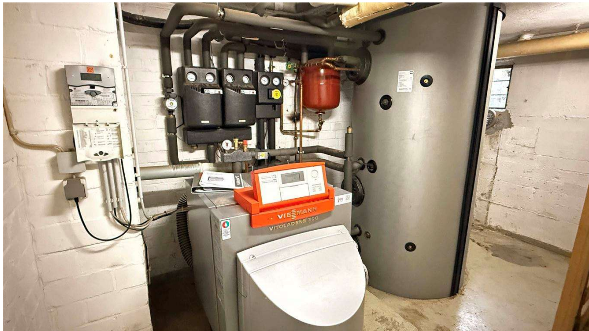
moderne Öl-Brennwert-Heizung, Baujahr 2008 mit Solar
