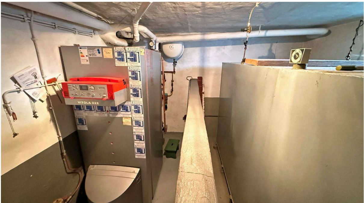
Öl- Zentralheizung Baujahr 2001
