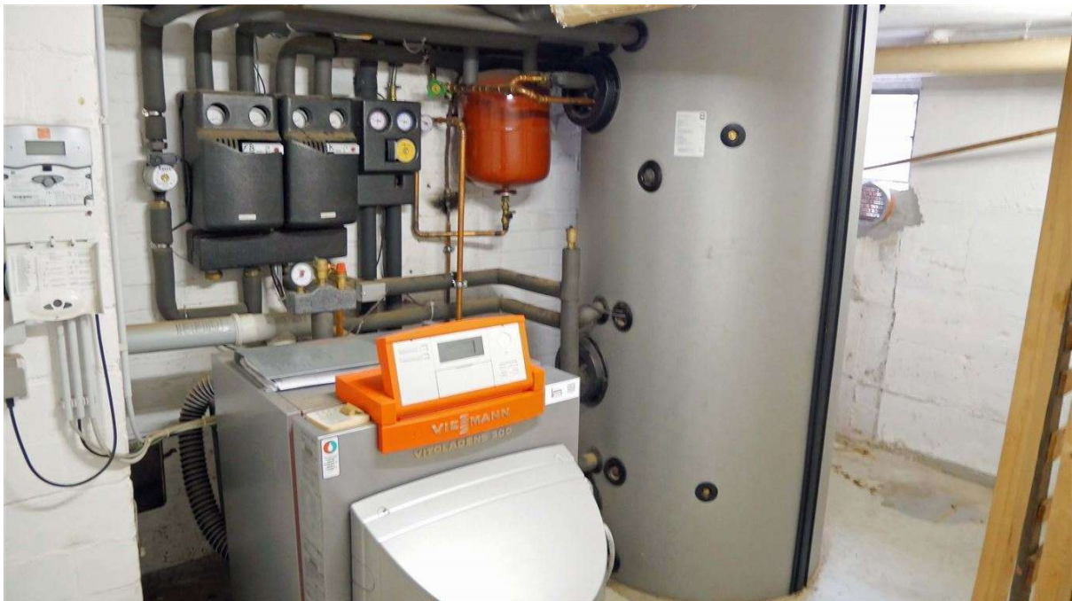
moderne Öl-Brennwert-Heizung, Baujahr 2008 mit Solar
