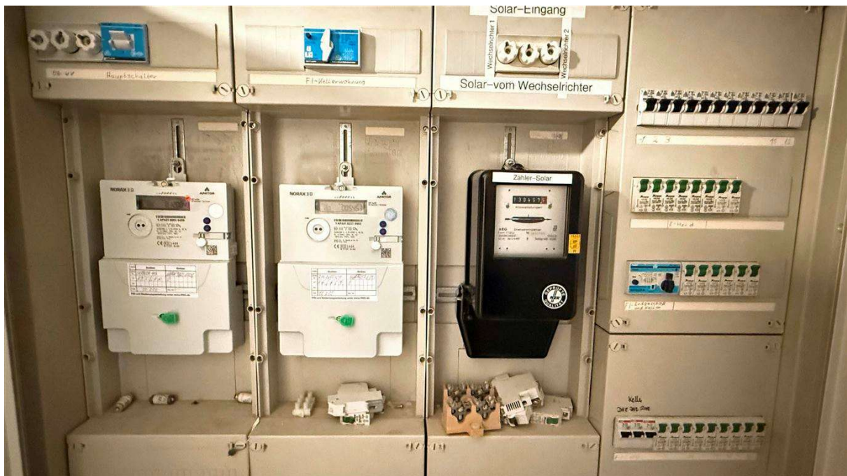
Separate Zähler für Strom, Wasser und Heizung
