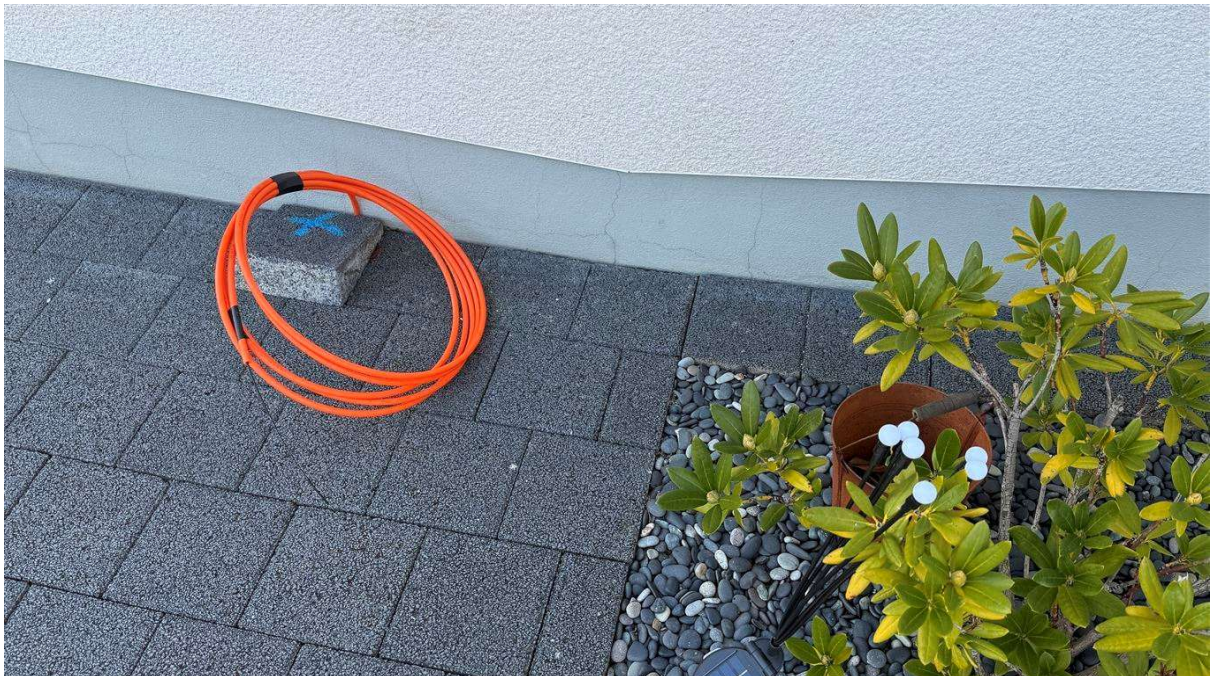
schnelles Internet garantiert: Glasfaserleitung
