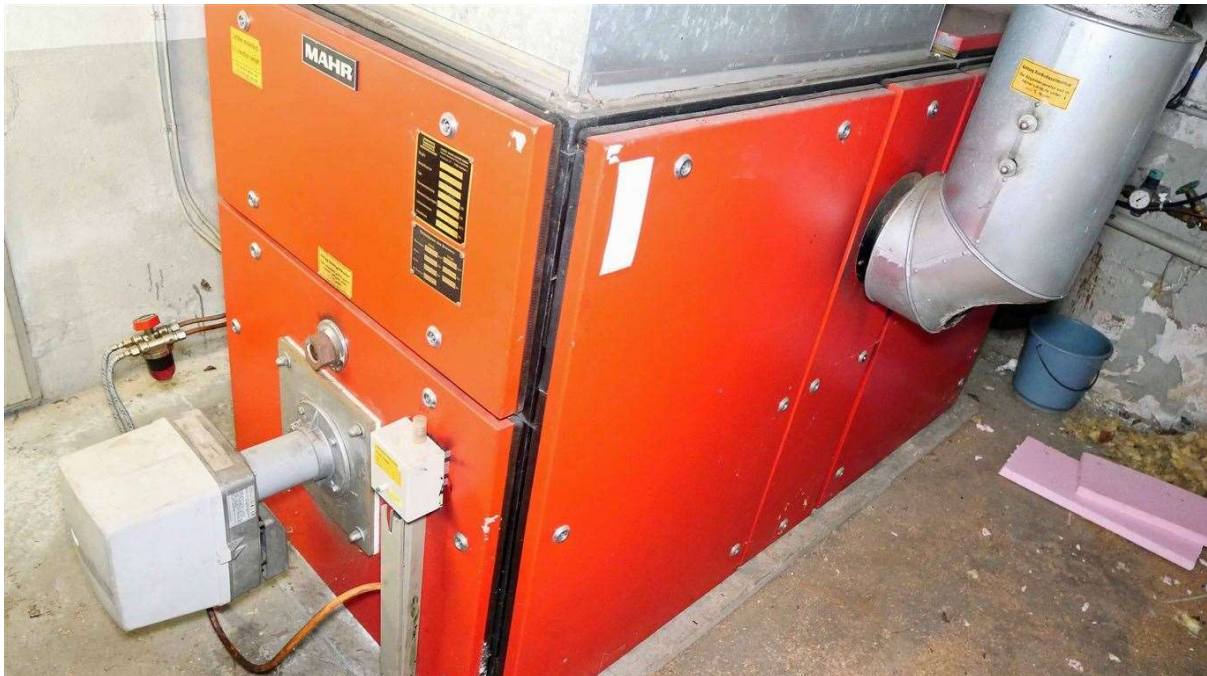
Ölheizung mit Warmluft-Gebläse
