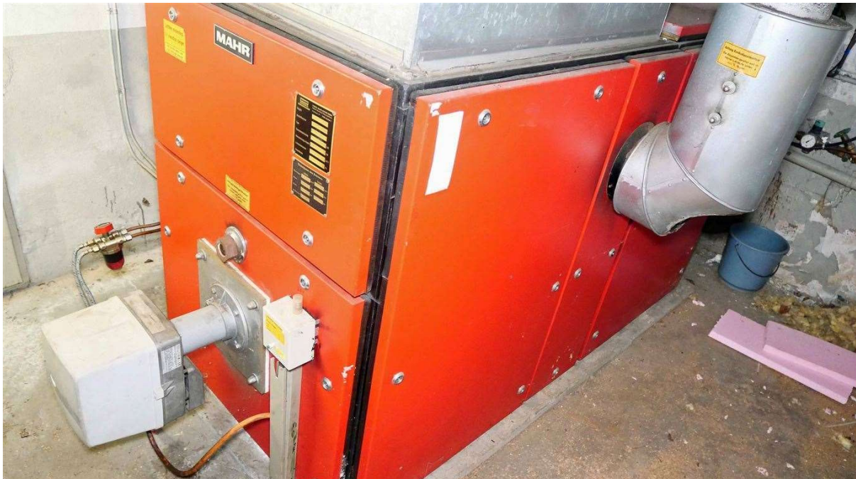
Ölheizung mit Warmluft-Gebläse
