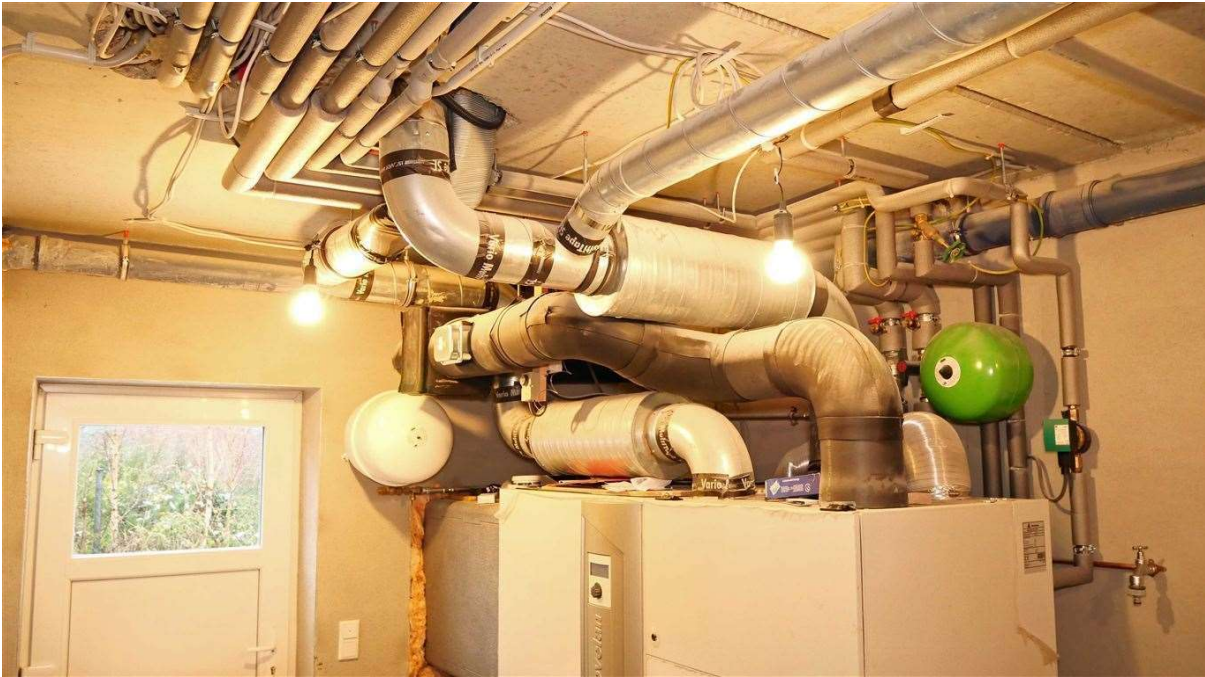
modernste Heiztechnik mit integrierter...
