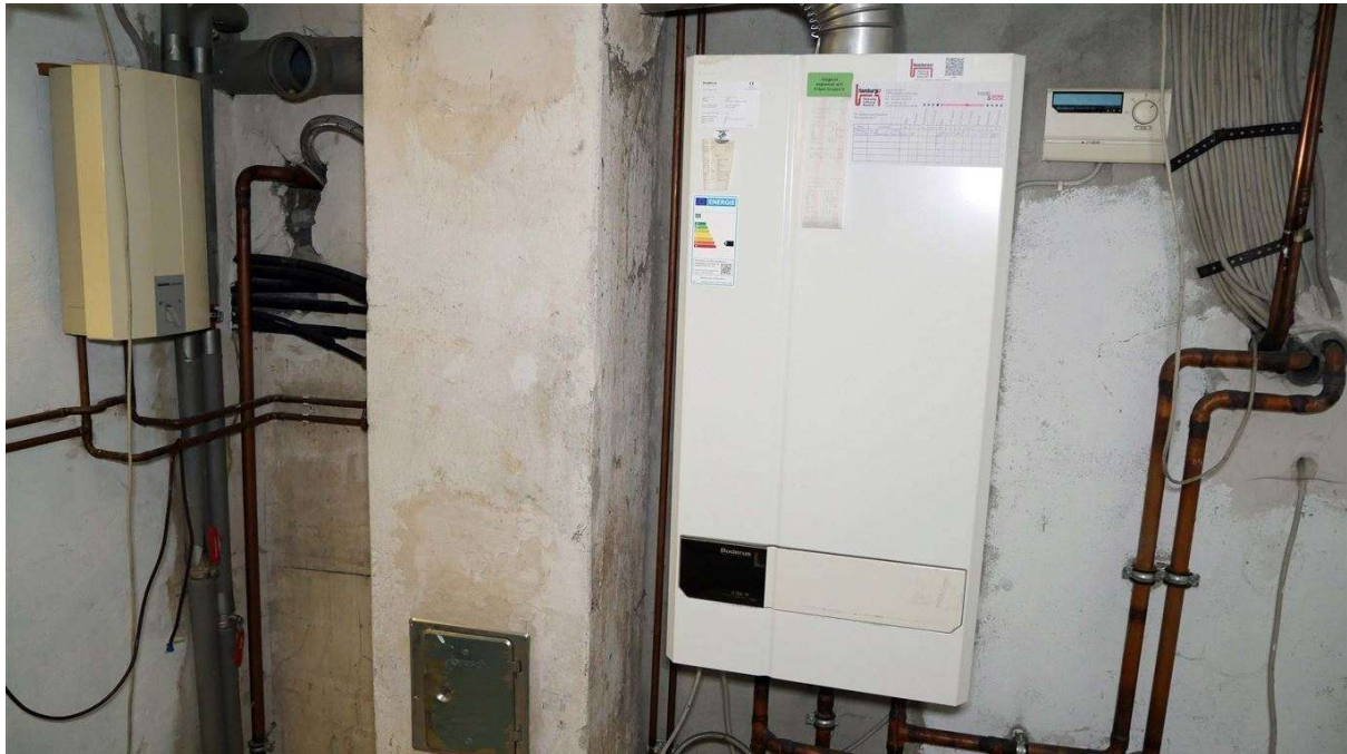
Erdgas-Therme für beide Gebäude (Baujahr 2000)
