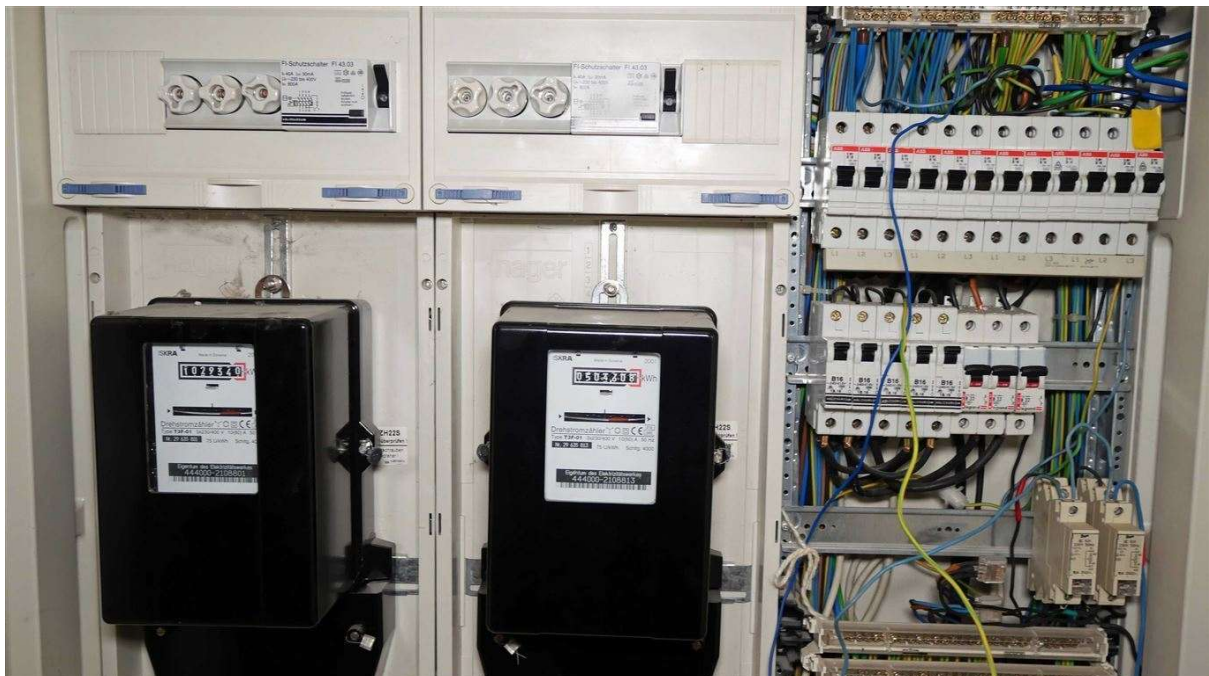
Elektroinstallationen wurden 1998/99 erneuert
