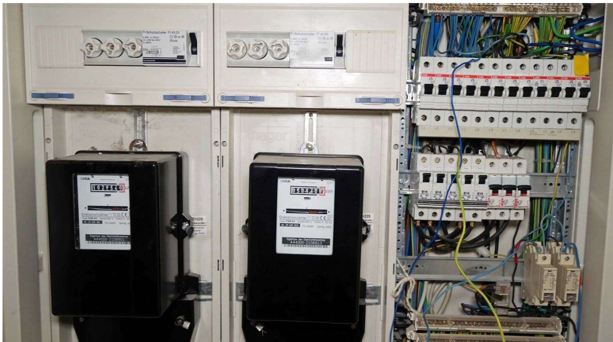
Elektroinstallationen wurden 1998/99 erneuert
