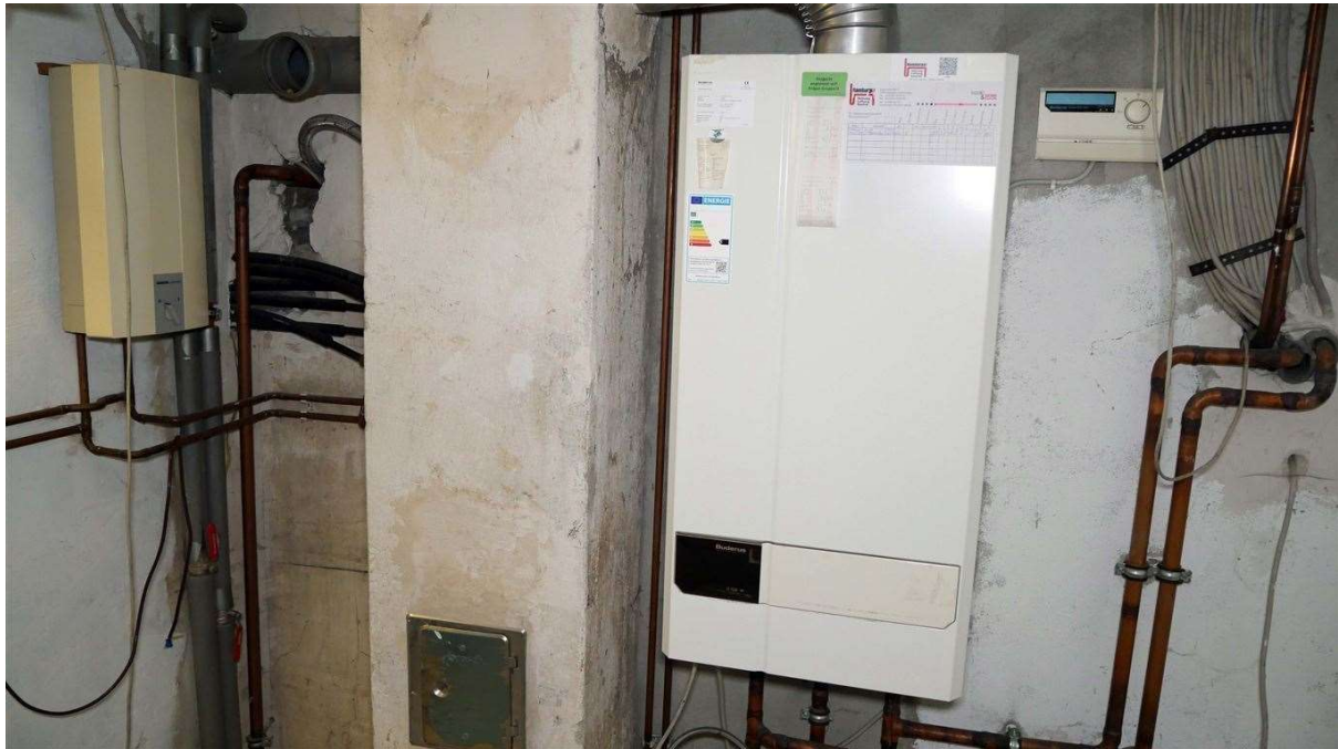
Erdgas-Therme für beide Gebäude (Baujahr 2000)
