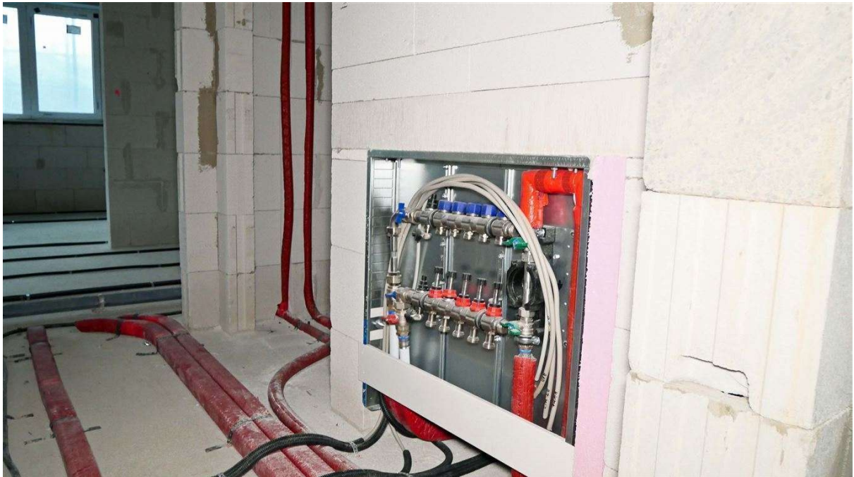
alle Wohnungen mit Erdwärme/ Fußbodenheizung...
