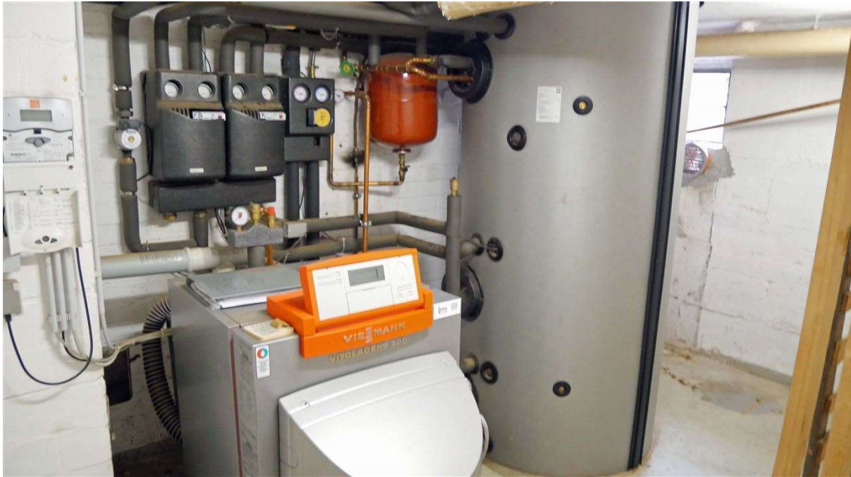
moderne Öl-Brennwert-Heizung, Baujahr 2008 mit Solar
