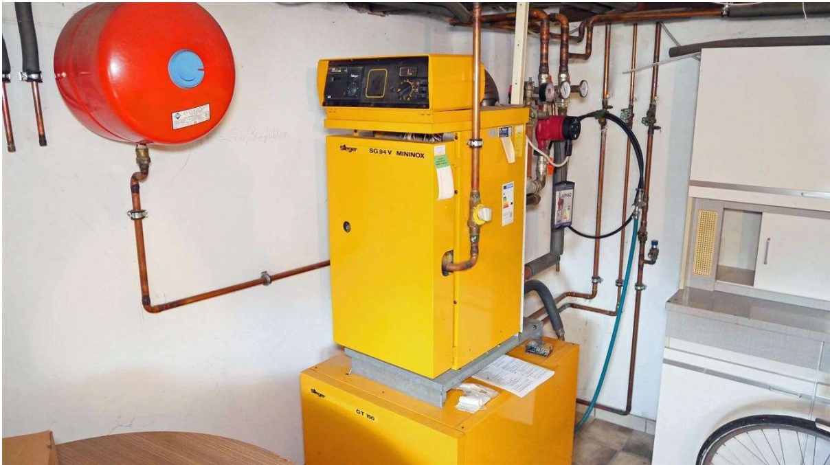
Erdgas-Zentralheizung mit WW-Speicher, Baujahr 1991
