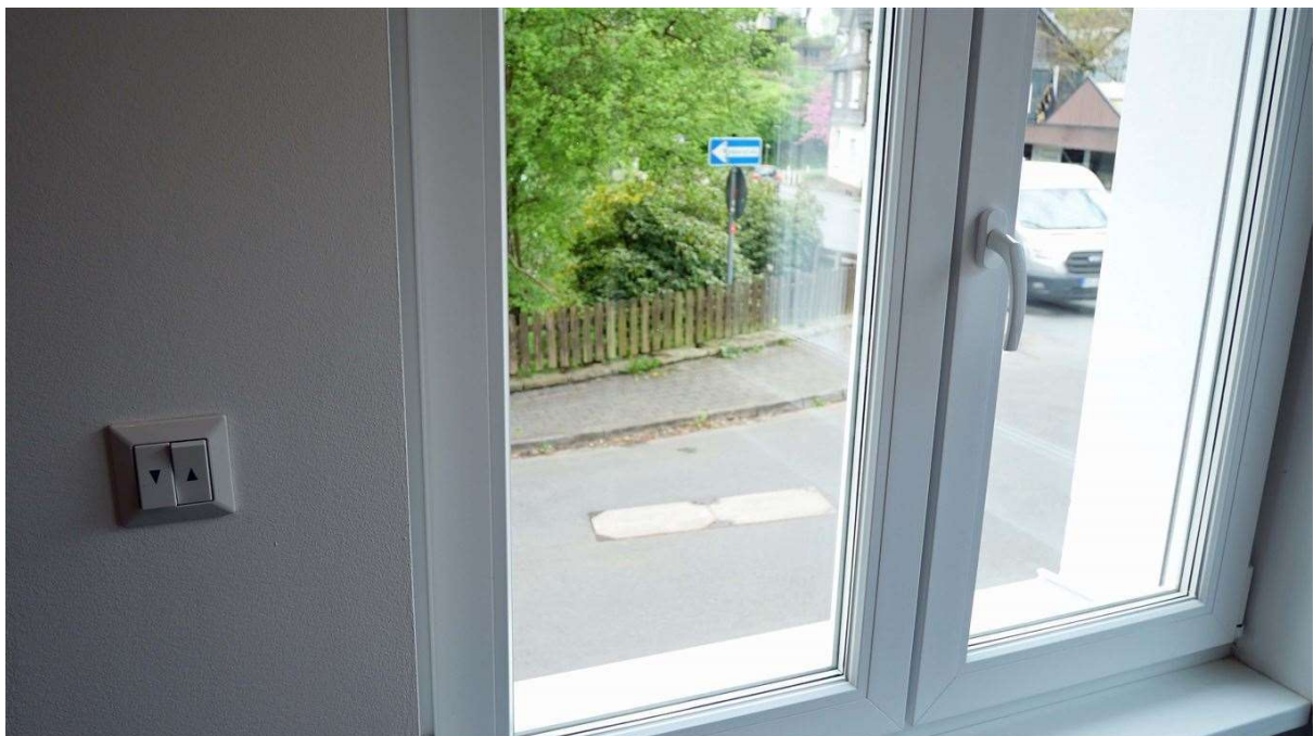
Fenster mit 3-fach Verglasung und elektr. Rollläden
