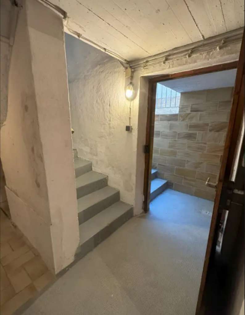
Zugang Keller vom Haus und Hof / Hausanschlussraum
