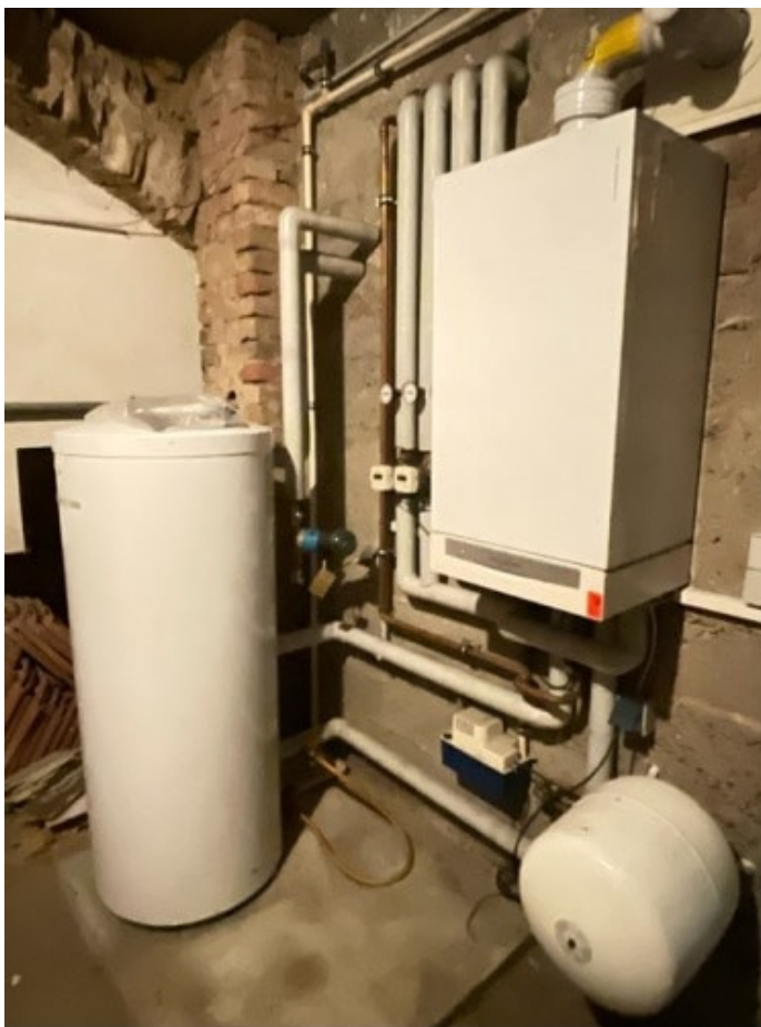
Gas-Heizungsanlage mit Warmwasserkessel
